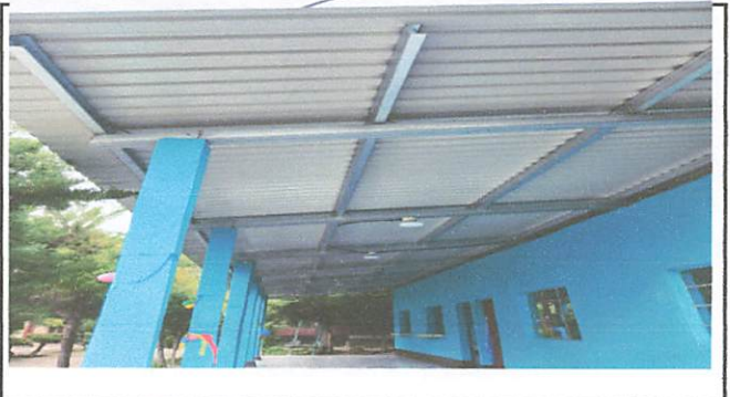
Foto 2: Sustitucion de estructura de techo de cocina con tubos galvanizada de 4x4 y 2x4 chapa 16
