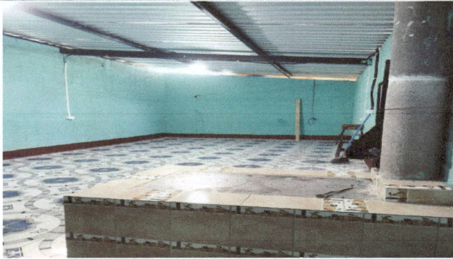
Aquí vemos la estructura metálica finalizada en el área de la cocina, el techado, electricidad y pintura en el interior
