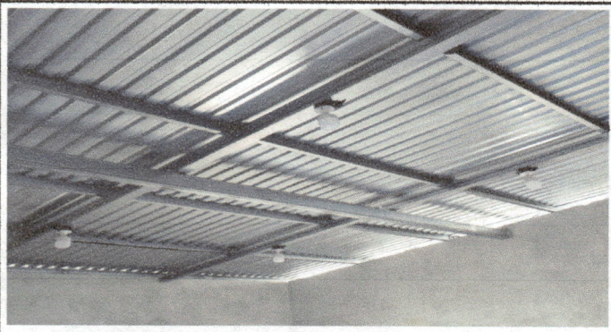
Foto 3: Sustitucion de estructura de techo de cocina de tubos galvanizada de 4x4 y 2x4 chapa 16 legitimo
