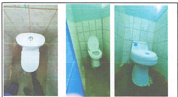
Foto 4: SUMINISTRO E INSTALACIÓN DE INODORO TIPO PUSH, SUMINISTRO E INSTALACIÓN DE ACCESORIOS DE INODORO
