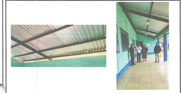
Foto1: SUMINISTRO E INSTALACIÓN DE ESTRUCTURA METALICA EN TECHO DE AULAS CON COSTANERAS DE 2" X 3" LEGITIMO
