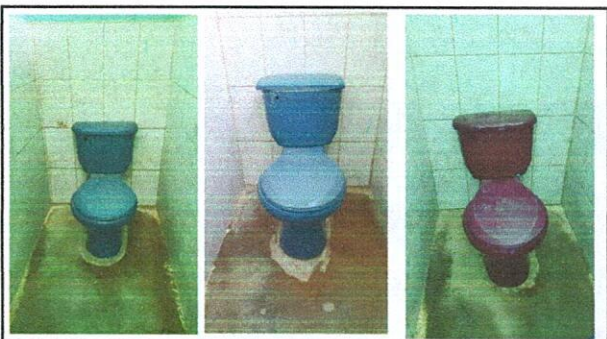
Foto 4: INODORO EN MAL ESTADO, CAMBIAR A INODORO TIPO PUSH.
