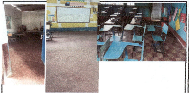
Foto 2: ES NECESARIO CAMBIO DE PISO EN LAS 2 AULAS Y DIRECCION.
