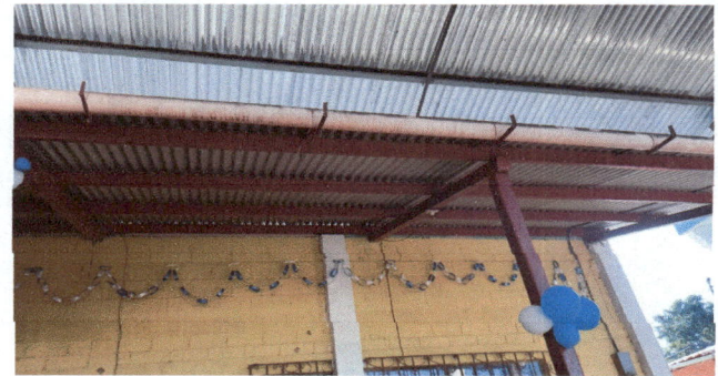
Foto 4: ES NECESARIO CAMBIO DE CANALES DETERIORADOS A CANALES NUEVOS.
