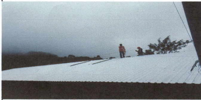
Foto 3: CUBIERTA CON NECESIDAD DE CAMBIO DE CAPOTE O CUMBRERA
