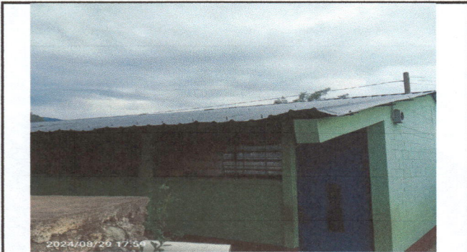
Foto 1: CUBIERTA DE LAMINA DETERIORADO, ES NECESARIO CAMBIO DE TECHO DE LAMINA.
