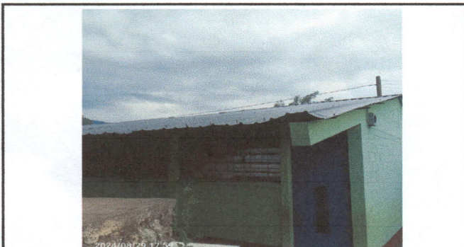
Foto 3: CUBIERTA CON LA NESESIDAD DE CAMBIO DE CAPOTE O CUMBRERA.
