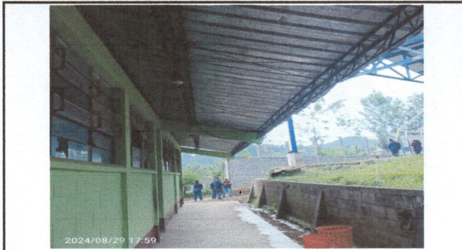
Foto 2: ESTRUCTURA PORTANTE TIPO JOIS OXIDADOS, SERA SUSTITUIDO CON COSTANERA GALVANIZADA + 3 TIJERAS CON TUBO DE 2"X4" GALVANIZADA.
