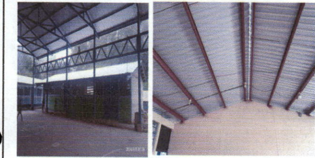
Foto1: SUSTITUCION DE LAMINA POR LAMINA TROQUELADA Y MANTENIMIENTO DE ESTRUCTURA PORTANTE DE METAL.
