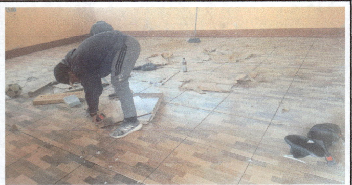
Foto 2: se muestra el proceso de colocación de azulejos en las aulas y zócalo
