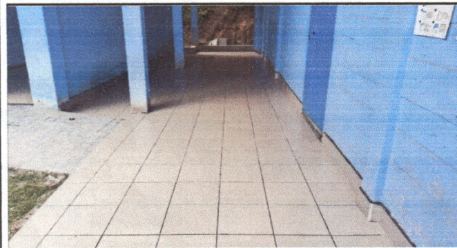
Foto 3: Suministro e instalación de piso cerámico en el corredor de las aulas.
