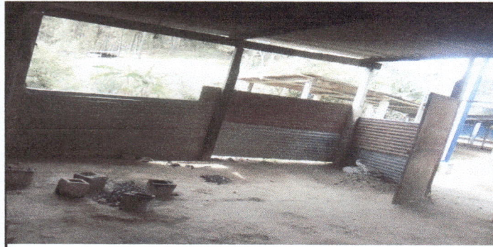
Foto 1: ES NECESARIO EL MANTENIMIENTO DE ESTRUCTURA DE TECHO EN COCINA.
