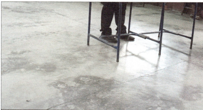
FOTO 9: PISO DE SALON DE CLASE EN MAL ESTADO, NECESITA CAMBIO
