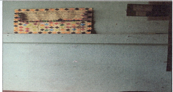
FOTO 8: PINTURA EN PAREDES DETARIORADAS, ES NECESARIO EL MANTENIMIENTO DE SALONES CON PINTURA NUEVA.
