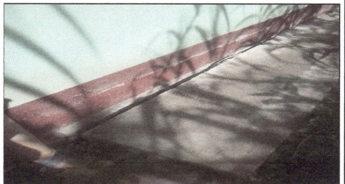
Foto 4: PARTES EXTERIOR DEL CENTRO EDUCATIVO CON DETERIORO, NECESITA REMODELAR
