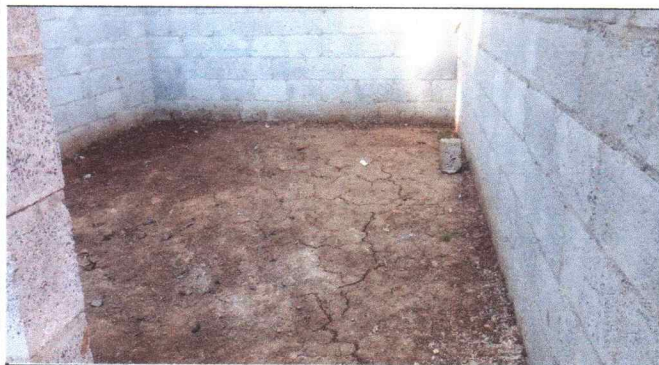
Foto 3: FALTA CONTRAPISO E INSTALACION DE PISO.
