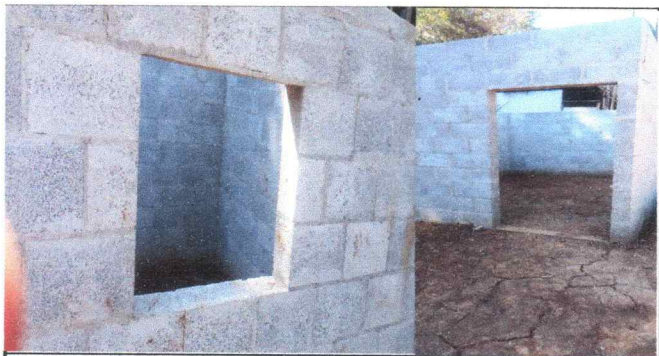
Foto 5: SE NECESITA PUERTAS Y VENTANA EN COCINA.
