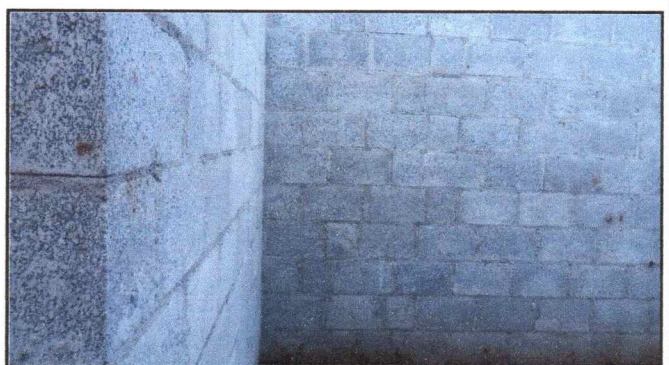
Foto 4: FALTA DE ACABADO EN PAREDES INTERIOR Y EXTERIOR
