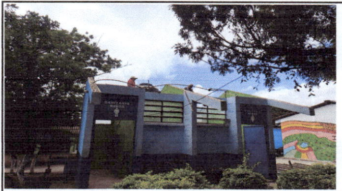
desmontaje de techo del area de sanitarios, pintura de costaneras y montaje de lamina croquelada.
