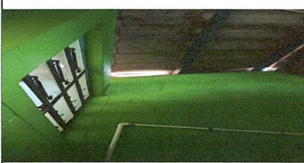
En esta fotografía se muestra el deterioro del techo, lo cual se cambiara por lamina
