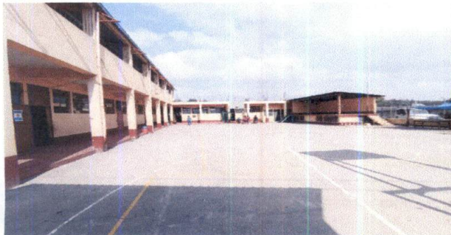
Foto 9: VISTA FRONTAL A ESTABLECIMIENTO CON MUROS MANCHADOS
