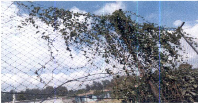
Foto 7: MALLA PERIMETRAL EN MAL ESTADO
