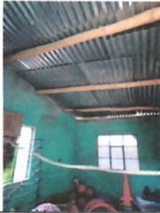
Foto 7: VISTA FRONTAL DONDE SE REMOZARA TECHO METALICO
