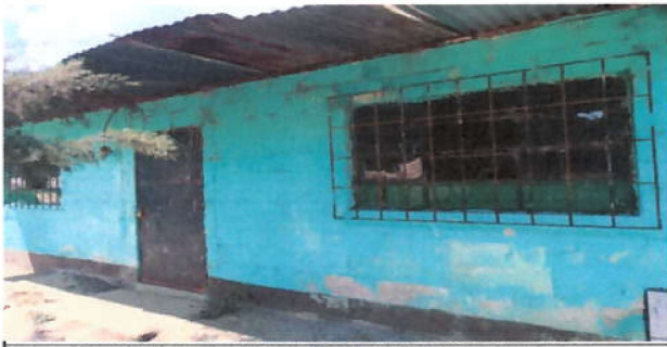
Foto 9: PUERTA DE METAL EN MAL ESTADO Y MUROS CON MARCAS DE HUMEDAD
