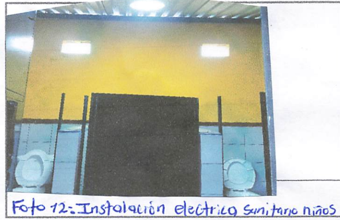
Foto 12: Instalación eléctrico sanitario niños
