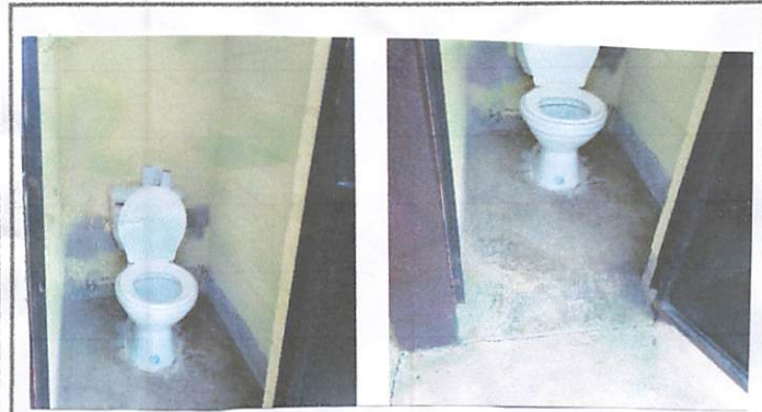
Foto 3: Piso: El piso en el Sanitario de maestras se encuentra ya muy deteriorado ya que es torta.
