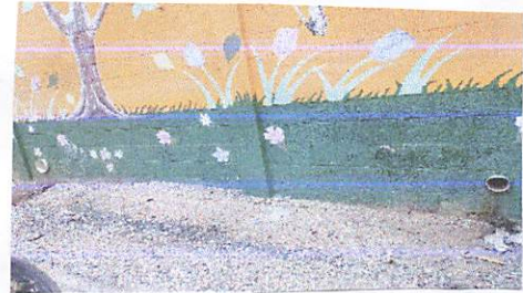
Foto 8: Banqueta, debido a que por la lluvia la pared se esta humedeciendo y esto estara su deterioro.
