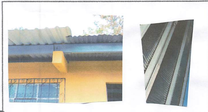
Foto 1: Lamina: Cambio de techo en un aula, por encontrarse muy deteriorada.
