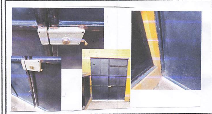
Foto 17: Porton: se traba la llave, se ha cambiado la chapa des veces esta en mal estado
