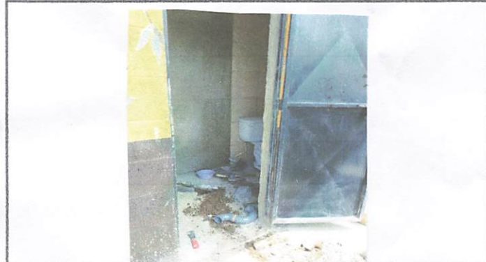
Foto 4: Lavamanos: No se cuenta con un lavamanos en el sanitario de maestras.
