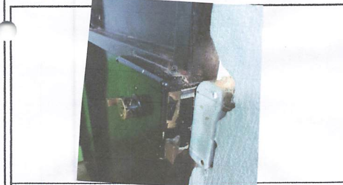
Foto 20: Reparación de puerta en bodega (biblioteca) no cierra ni abre
