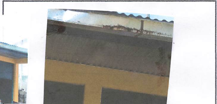
Foto 15: Canales en mal estado, picados.
