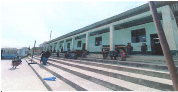
Foto 9: LAMINA DE MÓDULO DE AULAS EN MAL ESTADO
