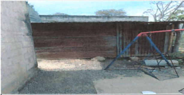
Foto 7: MURO DE LAMINA PORTANTE CON CORROSIÓN PISO DE TIERRA Y PUERTA DE LAMINA CON OXIDO
