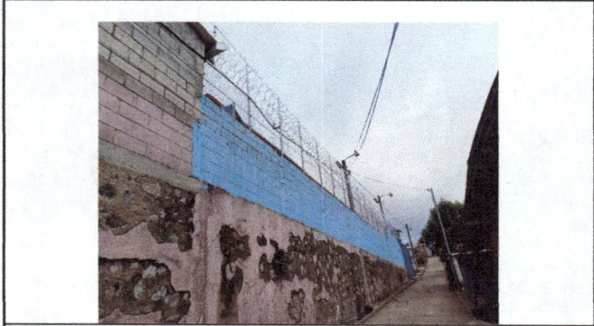
Foto 2: Instalación de Maya con alambre razor con electircidad
