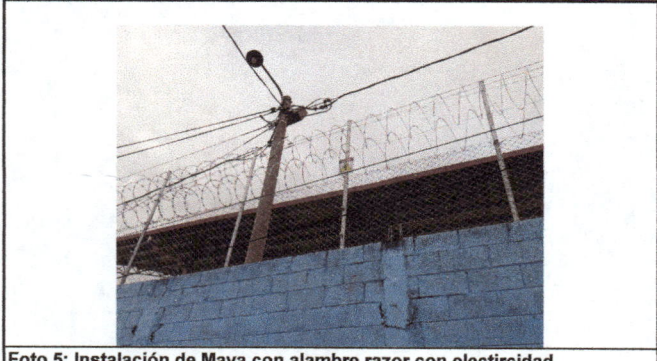
Foto 5: Instalación de Maya con alambre razor con electircidad
