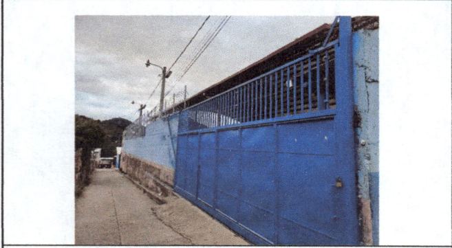
Foto 1: Instalación de Maya con alambre razor con electircidad
