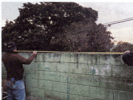
Foto 1: Medición para distancia de colocación de tubos parte de atrás de la escuela
