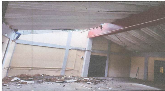
Foto 3: Techo del laboratorio en mal estado
