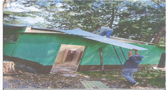
Foto 4: Techo en el baño
