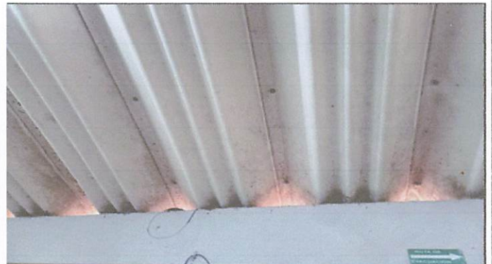
Foto 4: Techo en el laboratorio en mal estado.
