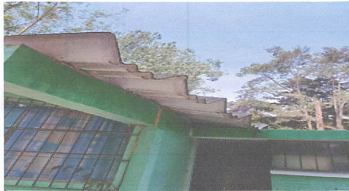
Foto 3: Techo del laboratorio en mal estado
