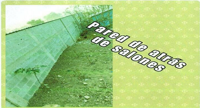
CERNIDO DE PARED DE ATRÁS DE LOS SALONES YA QUE SE FILTRA EL AGUA Y HAY MUCHA HUMEDAD DENTRO DE LOS SALONES.
