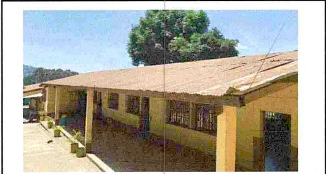
Foto 2: Aula con necesidad de cambio de cubierta.
