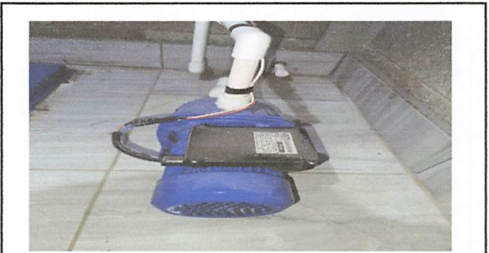
Foto 2: Bomba de agua instalada para funcionar.
