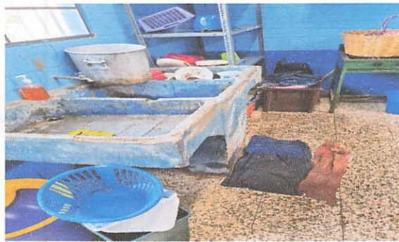
Foto 3: Pila con fuga de agua, por modificarse por elaboración de una
