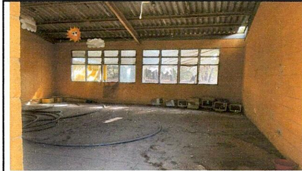
Foto1: CAMBIO DE TECHO Y HABILITACION DE ENERGIA ELECTRICA AREA DE BODEGA O BIBLIOTECA
