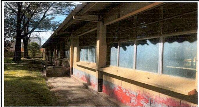
CAMBIO DE VENTANAS, TECHO, PINTURA INTERIOR Y EXTERIOR, COCINA Y PARTE DEL COMEDOR
