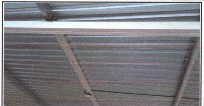
Foto 2: CAMBIO DE LAMINA DE AULA D CAMBIO DE LAMINAS EN MAL ESTADO DE AULAS B,C,D Y CORREDOR TRASLAPE DE AULAS A,B,C,D Y CORREDOR
