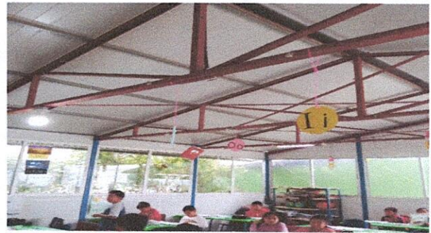
Foto 4: Falta de iluminación en salones
