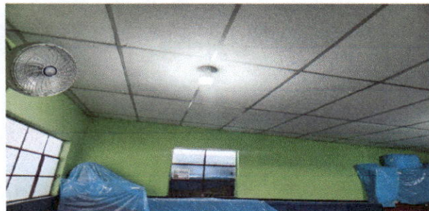
Foto1: Instalado el cielo falso en aulas y mejoramiento de ventilación en aulas
