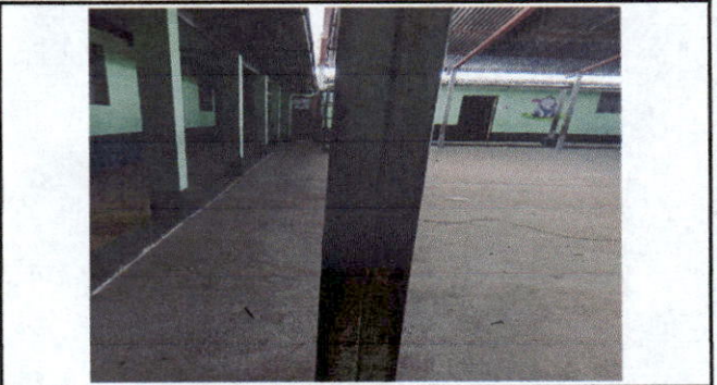
Foto 2: parales con pintura degradada
