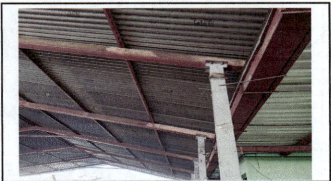
Foto 3: Techo y parales con pintura degrada
