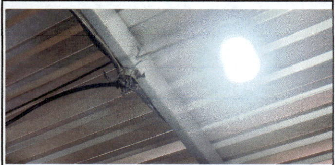
Foto 2: Cables pelados y separados en las aulas
