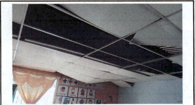
Foto 1: se puede observar que el cielo falso esta en mal estado
