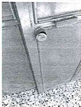
Foto 13: Sustrucción de chapa en una puerta
