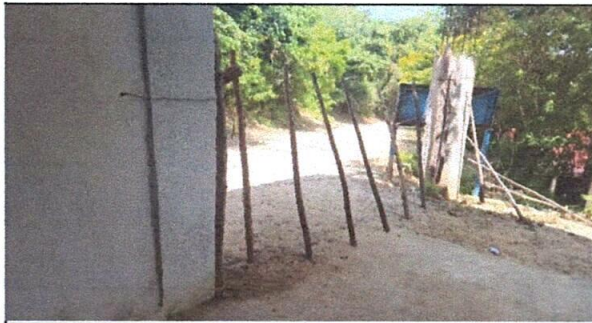
Foto 5: El portón del NUFED, no es más que un falso de alambre de púas, el cual no brinda la seguridad necesaria a los estudiantes. Es necesario un portón de totalmente de metal, para brindar la seguridad necesaria, tanto para los estudiantes como para el personal.
