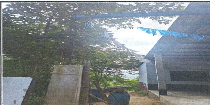
Foto 8: La columna de la entrada principal, destinada para colocar un portón a futuro, está incompleta.
