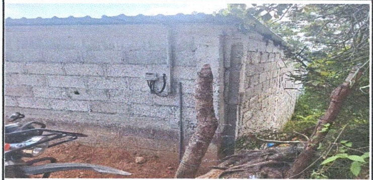
Foto 2: La pared frontal y lateral del establecimiento necesita repello de cemento y cernido, pues en el invierno, se filtra el agua hacia adentro, causando humedad excesiva, lo que daña la parte interna del aula.
