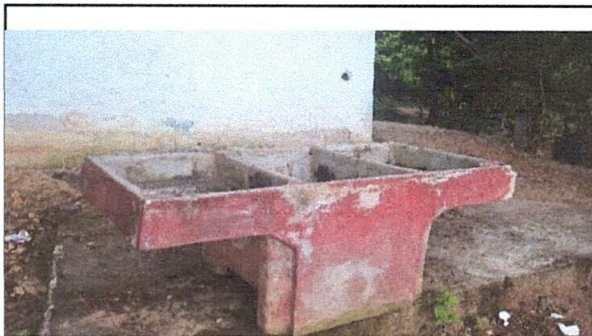
Foto 3: La única pila en el NUFED está en mal estado y no se puede guardar agua. Así mismo el repello de la pared, en la parte de abajo está en mal estado
