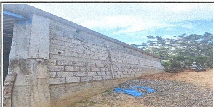
Foto 10: El muro perimetral que da hacia la calle principal, también sirve de pared para un espacio que se utiliza como corredor, sin embargo, es necesario una banquetta lado afuera para protección de la misma.
