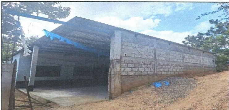
Foto 4: En el techo del establecimiento, hace falta, colocar laminas, que se quitaron debido al mal estado de las mismas, así mismo hace falta un portón formal en la entrada principal. El piso del un aula es de torta de cemento.
