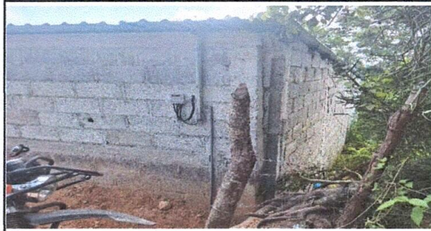
Foto 2: La pared frontal y lateral del establecimiento necesita repello de cemento y cernido, pues en el invierno, se filtra el agua hacia adentro, causando humedad excesiva, lo que daña la parte interna del aula.
