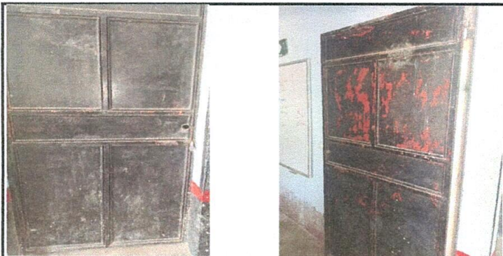
Foto 7: Las puertas de las únicas 2 aulas están en mal estado. La puerta del lado izquierdo no tiene chapa y la del lado derecho necesita restaurar la pintura
