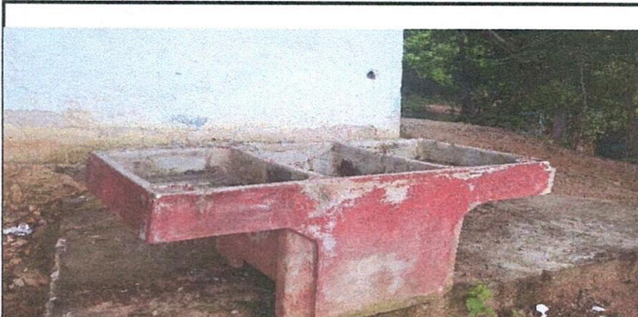
Foto 3: La única pila en el NUFED está en mal estado y no se puede guardar agua. Así mismo el repello de la pared, en la parte de abajo está en mal estado
