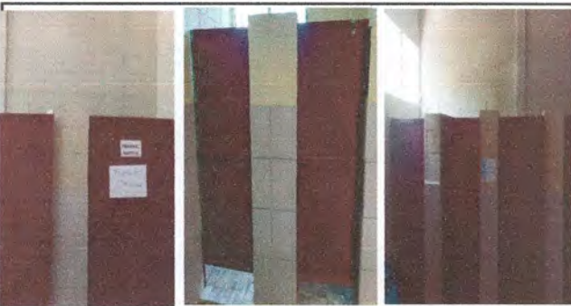
Foto 3 Servicios sanitarios y accesorios, pintura, pasadores se encuentran en mal estado, mantenimiento de estructura
