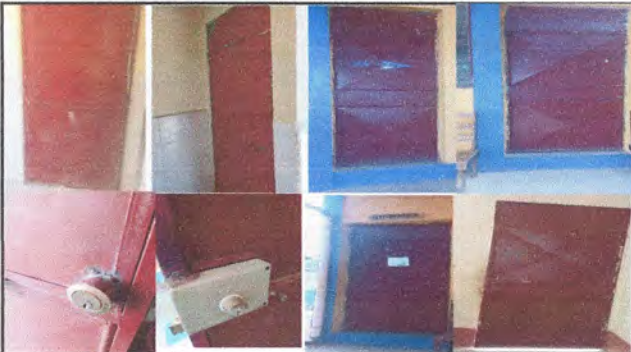
Foto1: Puertas de metal en mal estado y pintura deteriorada lo cual se requiere cambio de chapas dar mantenimiento a estructura
