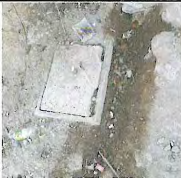
Foto 1: Sustrucción de caja de contador
