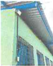
FOTO 4: Lámparas led instaladas
