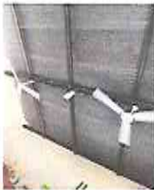
FOTO 3: Ventiladores instalados en los salones
