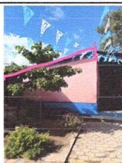
Foto 2. Ampliación de mojinete para ampliar inclinación (se levantará la pared para colocar la estructura metálica debido a la generación de humedad y filtración de agua.
