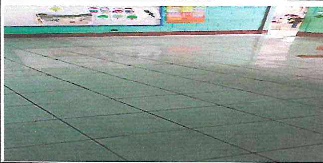
Foto 1: 1.1 PISO CERAMICO ANTIDESLIZANTE EN AULAS
