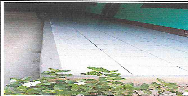
Foto 3: 2.1 PISO CERAMICO ANTIDESLIZANTE EN CORREDOR.
