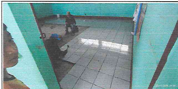
Foto1: 1.1 PISO CERAMICO ANTIDESLIZANTE EN AULAS
