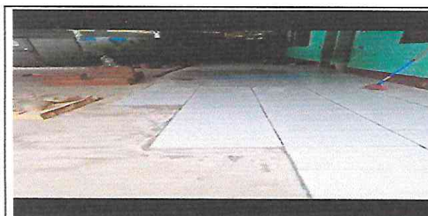
Foto 3: 2.1 PISO ANTIDESLIZANTE EN CORREDOR
