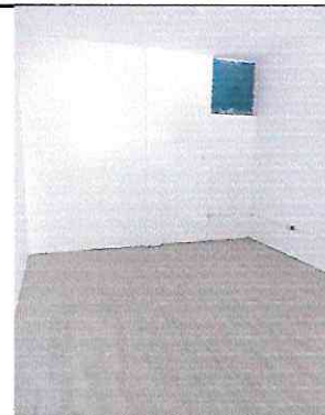
Foto 4: Cernido en muros de aula
