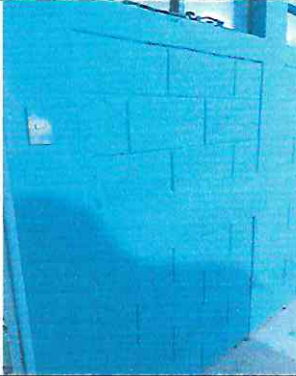
Foto 1: Pintura en Muros en Aula
