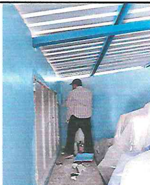
Foto 15: pintura en muros interiores de cocina
