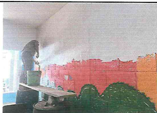
Foto 4: Cernido en muros de aula
