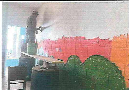
Foto 3: Cernido en muros de aula
