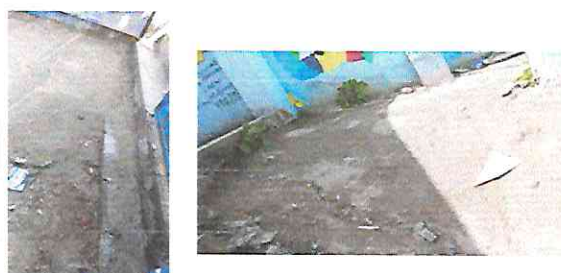
Foto 20: Sustitución de piso de torta de concreto, el actual esta deteriorado por lo que es necesario hacer la sustitución
