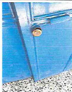
Foto 13: Sustrucción de chapa en una puerta
