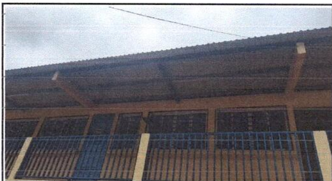
Foto 3: Instalación de soporte o pescante de metal para canal
