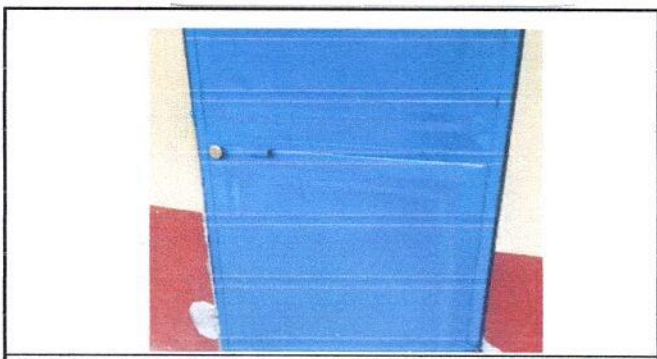
Foto 5: Sustrucción de chapa en puerta de centro de computación.
