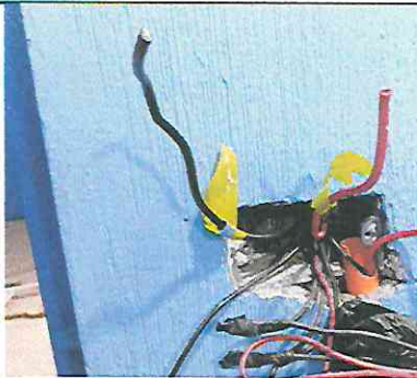
Foto 13: Sustrucción de cableado electrico incluye fase y neutro
