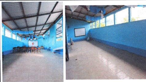
Foto 2: MUROS INTERIORES PINTADOS REMOZADOS
