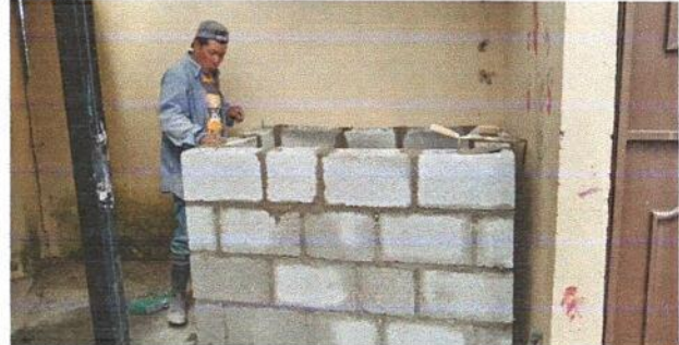
Foto 8: Sustrución de pila de cemento de 1 lavadero
