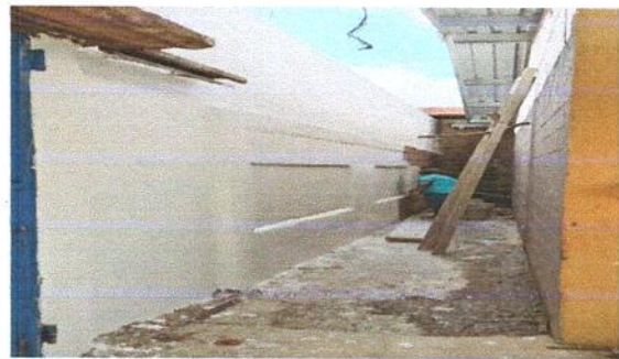
Foto 10: Repello en muro del ingreso de la entrada principal
