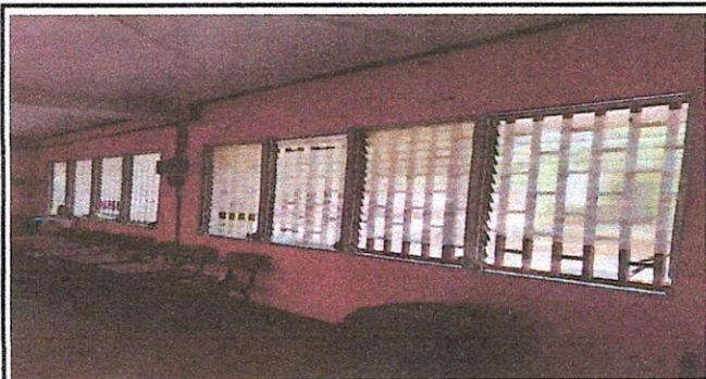
Foto 6: ANTES Ventanas de PVC corredizas en Centro de Computación lado interior derecho
